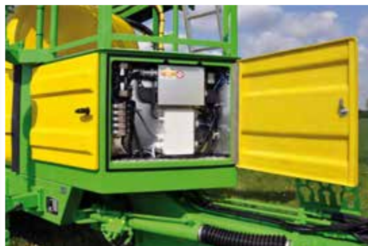
Dôležité časti ako elektrické ovládanie, armatúry a čerpadlo sú chránené voči vonkajším vplyvom.
